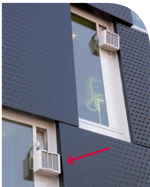
Toepassing van een lokale airconditioning als 'tijdelijke' oplossing. Omdat de condensor (de warme kant van de airco) voor de enige toevoeropening voor de ventilatie hangt, wordt (nog) warmere lucht het lokaal binnengehaald, zodat naast het hoge energiegebruik van de airco-unit tevens energievernietiging plaatsvindt.
