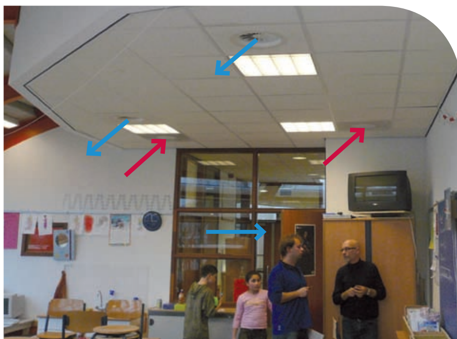
Toevoerroosters (pijl omlaag) en afvoerroosters (pijl omhoog) op zeer korte afstand van elkaar. De toevoer is tevens gesitueerd zeer nabij de (vaak openstaande) deur (horizontale pijl). De ventilatie-efficiency is daardoor zeer slecht.
