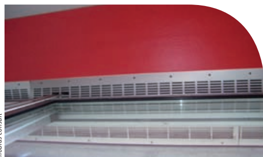
Toevoervoorzieningen weggewerkt in het plafond (aanzicht van onderaf). In deze situatie is niet te zien of roosters open of dicht staan.
