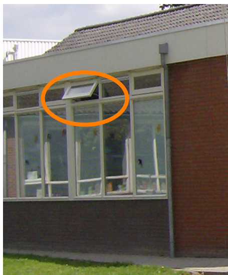
Figuur 2: Klepramen hoog in de gevel (links) en grote ramen om te luchten (rechts) - bron: W/E adviseurs
