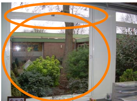
Figuur 2: Toe- en afvoer: klepramen en grote te openen ramen (linksboven), overstroomvoorziening tussen groepsruimte en gang (rechtsboven), mechanische afvoer in ganggebied (onder) - bron: W/E adviseurs
