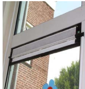
Figuur 2: Ventilatie-roosters (linksboven), toevoer balansventilatie (midden- en rechtsboven), afvoer ventilatielucht (onder) - bron: W/E adviseurs)
