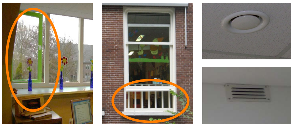
Figuur 2: Ventilatie door te openen ramen (links en midden), afvoerventiel (rechtsboven) en afvoerrooster (rechtsonder) - bron: W/E adviseurs
